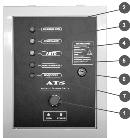
Рис. 14 Контрольная панель блока ATS
